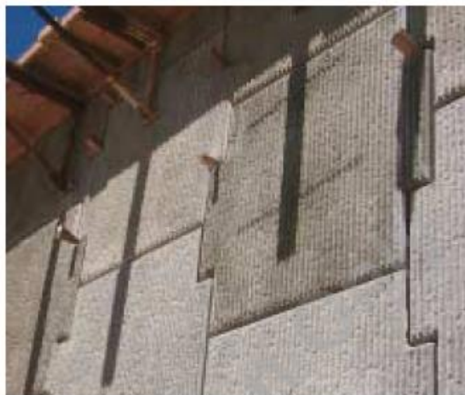
Fig. 1.9 : Wooden wedges (source : MSE Wall Inspector's Handbook, Paul D. Passe 2000)
